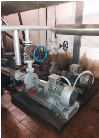
Slika 11. Pumpa 1 (lijevo) i Pumpa 2 (desno)
