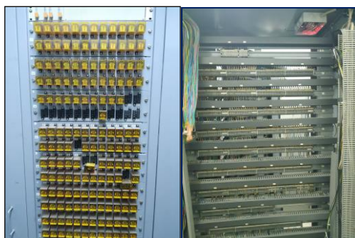
Slika 2. Ormar galvanskog razdvajanja s prednje strane (lijevo) i sa zadnje strane (desno).
