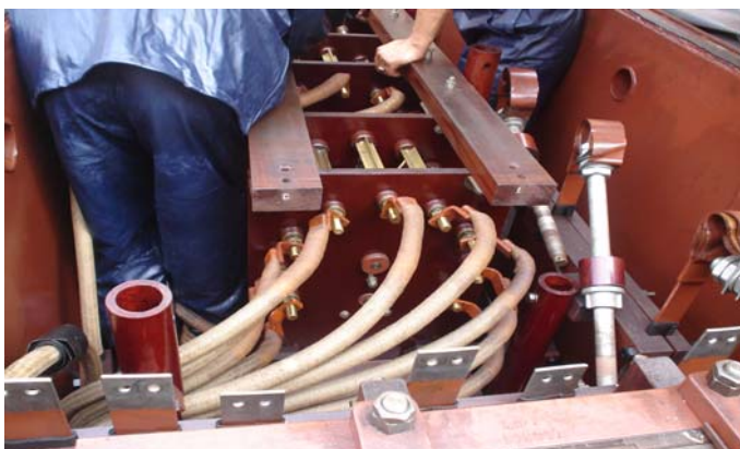
Slika 3. Fizički prikaz regulacione sklopke sa priključkom na transformatoru
