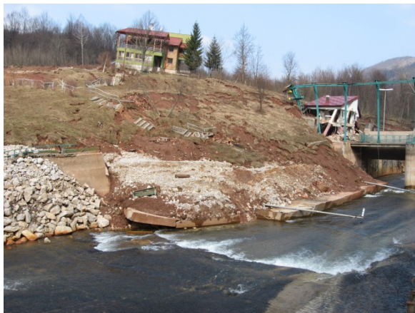
Slika 1. Klizište u blizini male hidroelektrane Bogatići na rijeci Željeznici [9]
