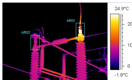
Slika 5. Termogram sabirničkog rastavljača F4 u DV 110 kV Goražde 2
