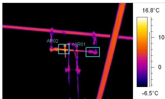
Slika 4. Termogram sabirničkog rastavljača sistema II u trafo polju T2 400 kV
