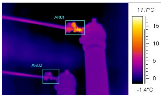
Slika 11. Termogram prekidača F4 u DV 110 kV Višegrad
