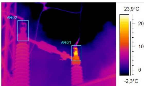
Slika 8. Termogram linijskog rastavljača F4 u DV 110 kV Višegrad
