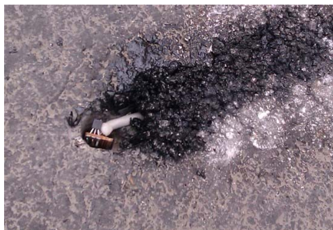
Slika 3. Postavljanje držača senzora u asfalt i njegovo zaptivanje radi zaštite od vlage i mehaničkog oštećenja.
