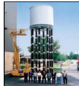
Slika 12. Reaktor sa vazdušnom izolacijom u HVDC proj. "Tian Guang".
