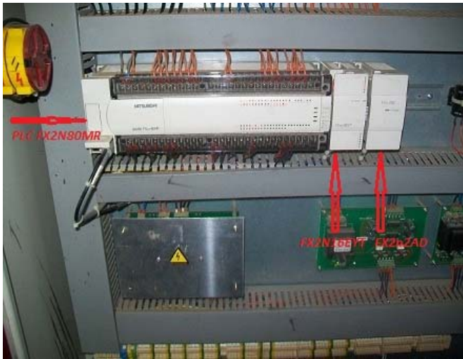
Slika 1. Prikaz PLC FX2N80MR smješten u ormaru mašine
