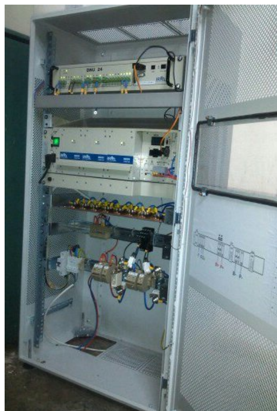
Slika 2. Pomoćno napajanje SN12110V sa dodatnim sklopovima
