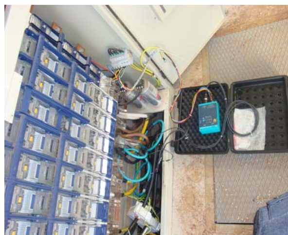
Slika 1. Izgled mjernog mjesta u MBTS sa mjernim uređajem
