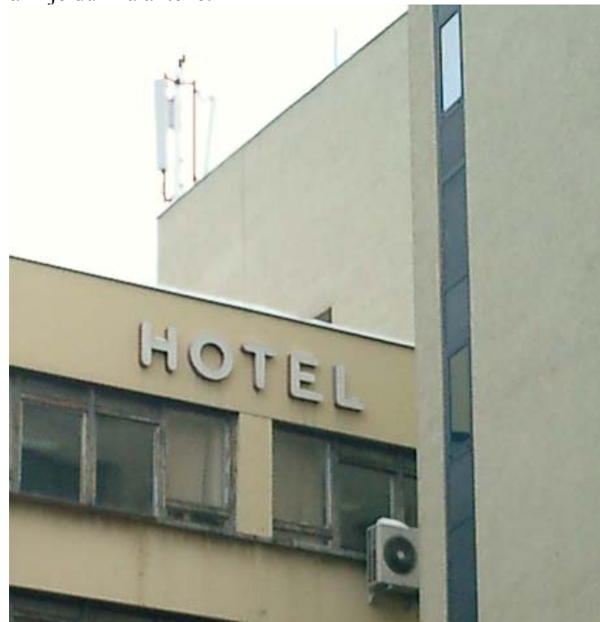
Slika 5 GSM antene instalirane na krovu u visini tijela
