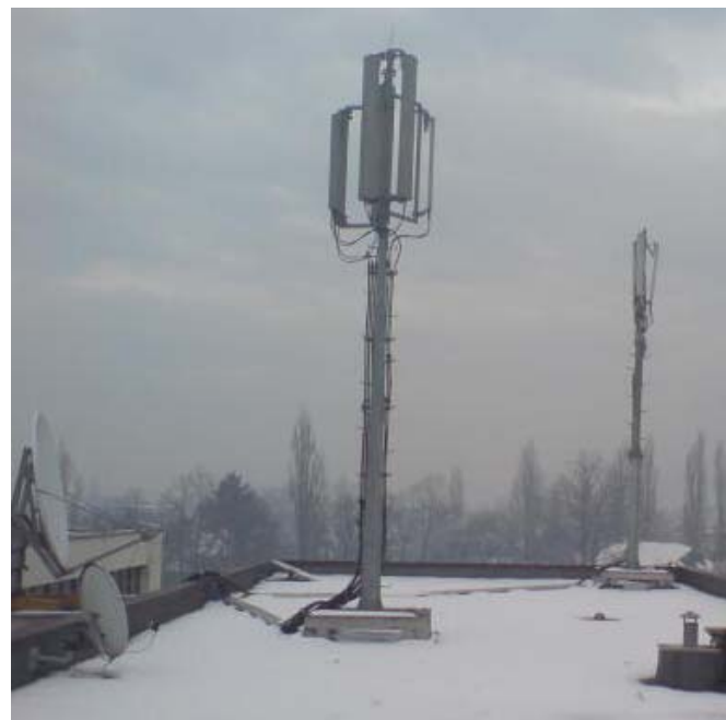
Slika 6. GSM900 antene instalirane na krovu, na visini preko 3.5 m
